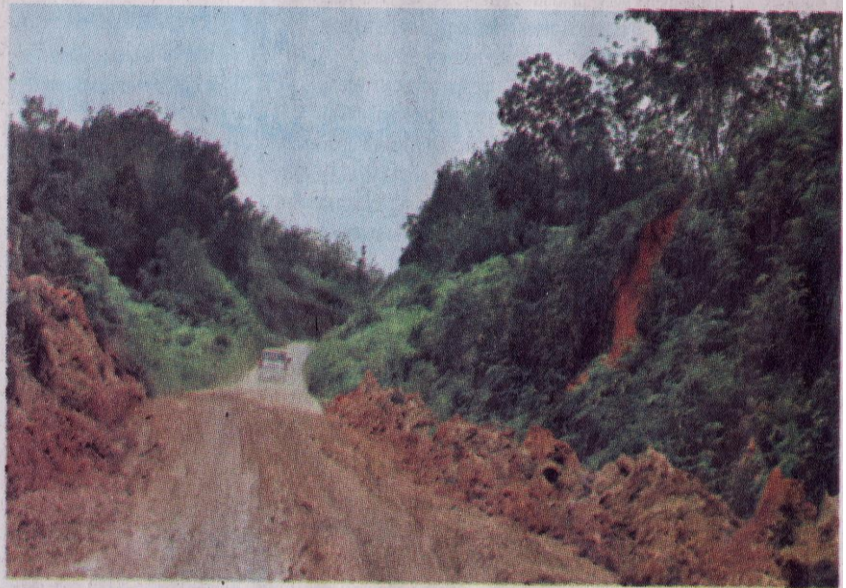
JALAN yang rusak di Desa Koto Tuo, Kecamatan XIII Koto Kampar.
